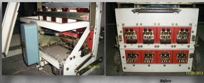
RETROFIT ACB TOSHIBA
